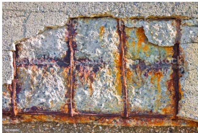
Figura 1. El efecto deletéreo de los microorganismos está relacionado, con la producción de metabolitos agresivos que afecta el refuerzo metálico del concreto.
